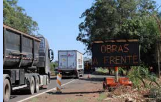
Sinalização deve ser respeitada para garantir a segurança de todos
